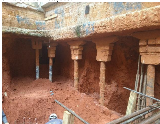
Figura 7. Estacas mega apoiando a fachada, com escavação até a cota do subsolo.
