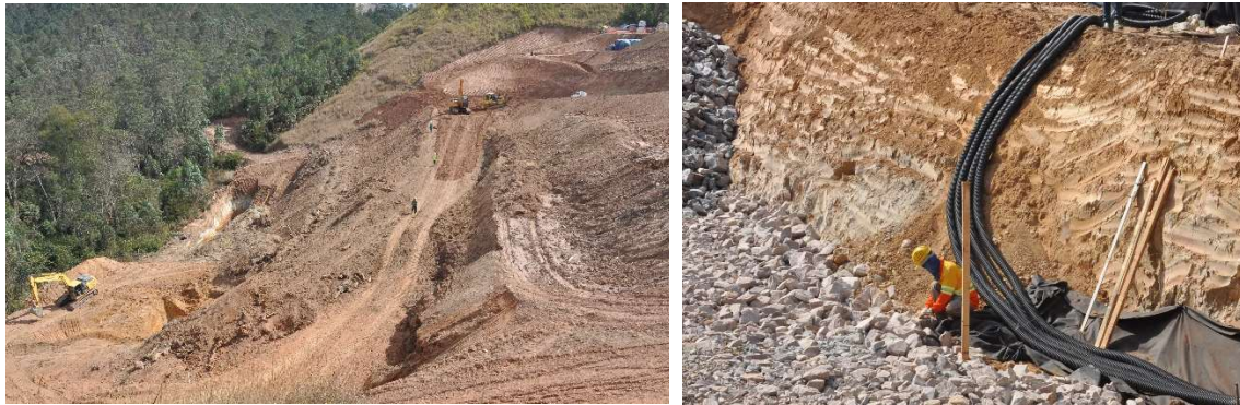
Figuras 8 e 9 – Fase inicial da obra com as escavações da fundação e detalhe do dreno de base.
