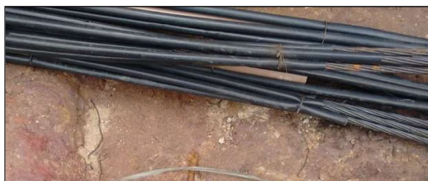
Figura 08. Vedação da transição entre o trecho livre e ancorado com a utilização de arame recozido, procedimento comum nos canteiros de obra
