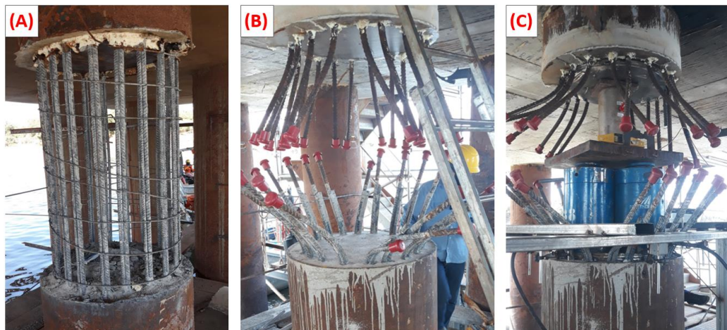
Figura 7. (A) após corte da camisa e remoção do concreto, (B) leve abertura na armadura para possibilitar inserção dos equipamentos e (C) inserção das placas, macacos e célula de carga
