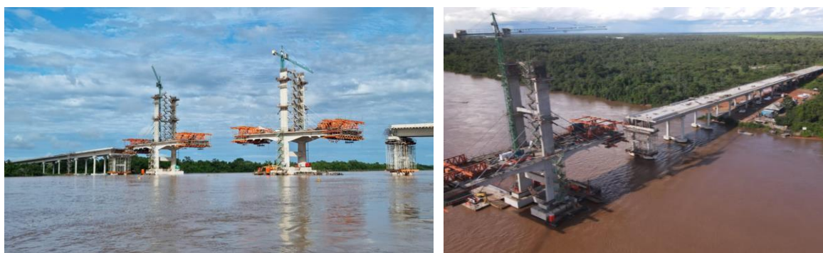
Figura 5. Estágio de construção da OAE, já avançado com pilares, tabuleiros e mastros construídos
