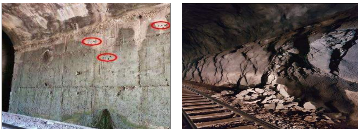
Figura 3 - À esquerda, destaque para as perfurações empíricas realizadas no túnel 8, a fim de possibilitar escoamento da drenagem; à direita, destaque para os deslocamentos de concreto projetado nas paredes do túnel 7.
