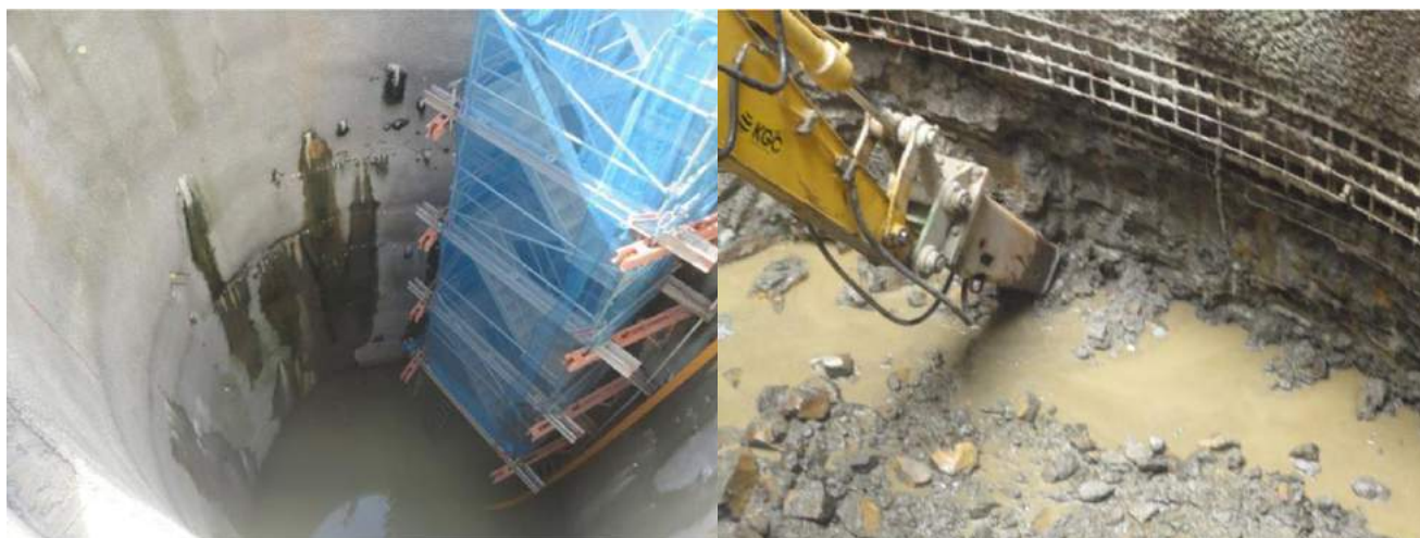
Figura 8 - Detalhe do poço 2 (a) início do esgotamento de água e (b) escavação com picão em trecho de solo saprolítico. (Fonte: ATO GeoCompany)
