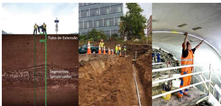
Figura 5 - Tipos de aplicação de monitoramento com recurso a SAA (vertical, horizontal e convergência)
