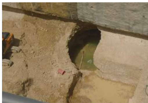
Figura 11 - Cavidad detectada en el fondo de la excavación
