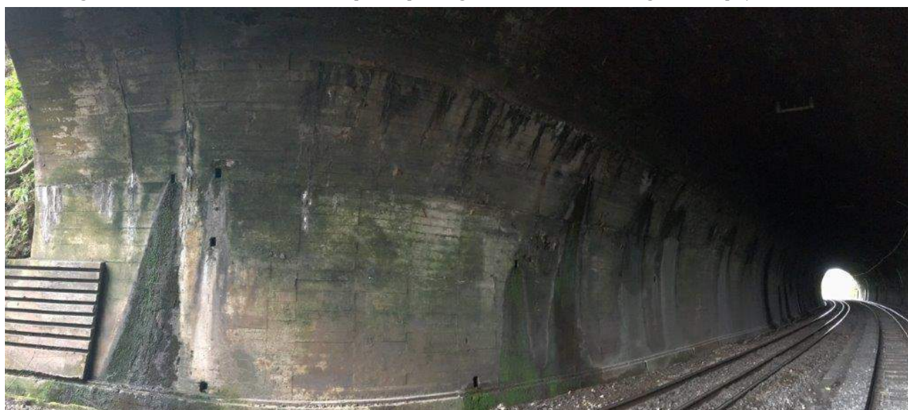
Figura 9 - Visão panorâmica de patologias encontradas ao longo dos túneis
