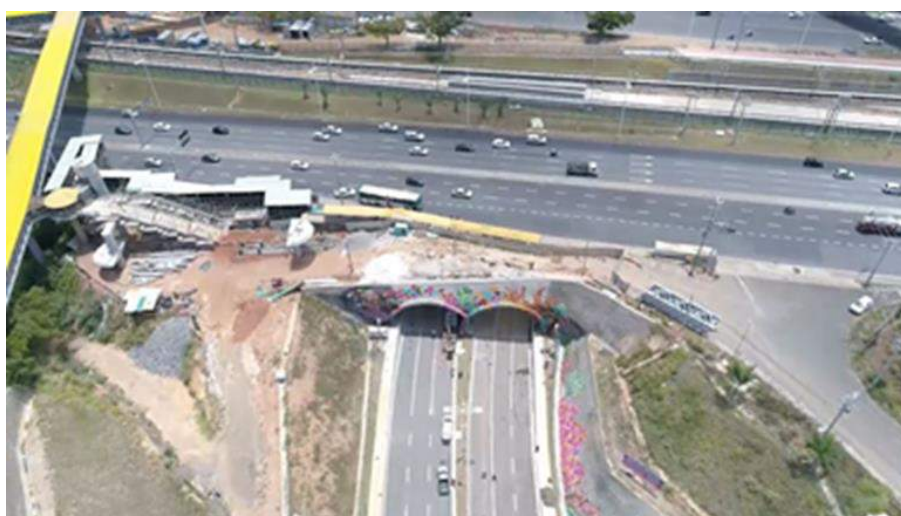
Figura 15 - Vista aérea com destaque para os túneis gêmeos de baixa cobertura sob a Av. Paralela sentido Aeroporto – Av. General Costa, Salvador, BA (Projeto Maffei, 2017).
