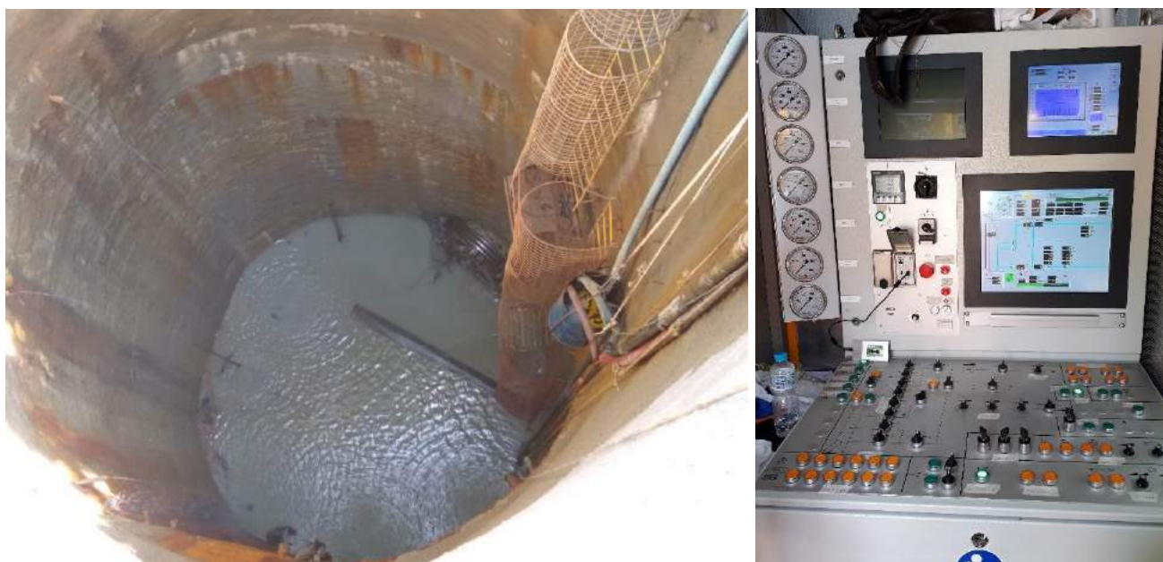
Figura 5 - (a) Vista do desemboque do shield , sendo possível observar que o equipamento ultrapassou as telas metálicas utilizadas no revestimento do poço. Foi utilizada água no interior do poço para balancear a pressão na chegada do equipamento e (b) cabine de controle do equipamento. (Fonte: ATO GeoCompany)
