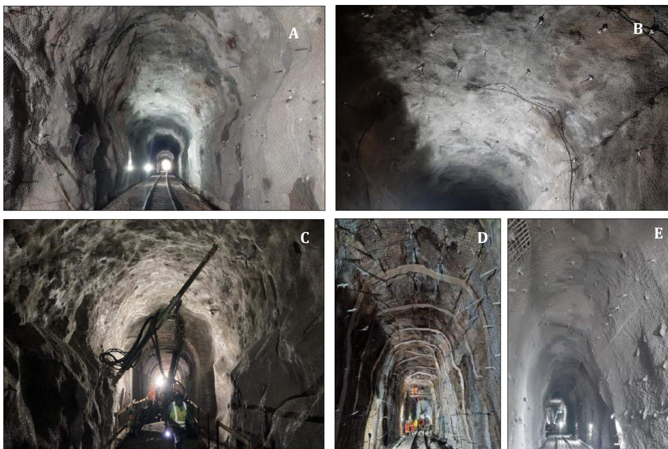
Figura 6 - A) ilustra o sistema de tela de alta resistência instalado nas paredes e tetos do túnel 8; B) temos o sistema de DHP finalizado; C) apresenta a execução de perfuração com apoio do trem de serviço; D) mostra a instalação de tela e sistema de drenagem para o concreto projetado; E) apresenta a execução do concreto projetado.
