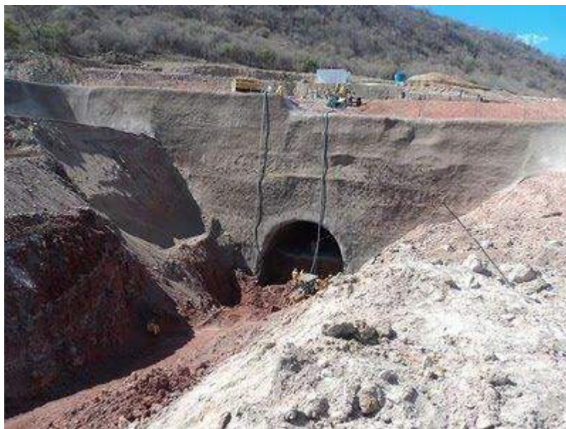
Figura 5 - Deslizamento ocorrido na entrada do Túnel Cuncas I.
