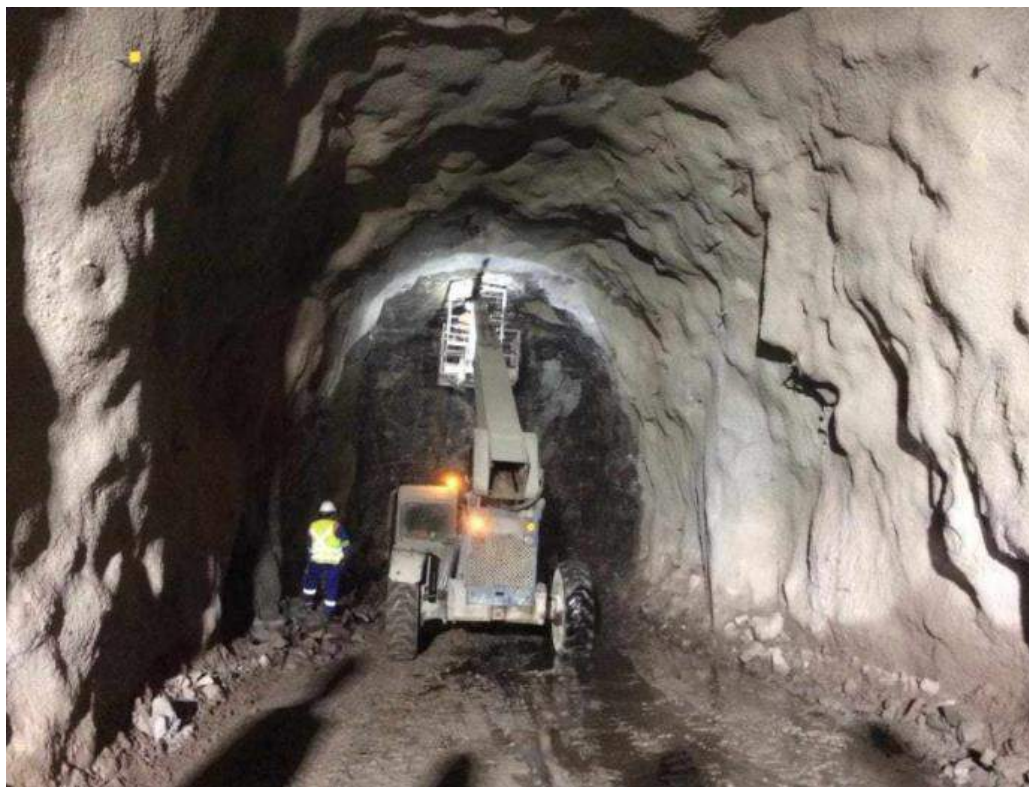
Figura 4 - Bate choco manual retirando pequenos volumes de rochas fraturadas. Fonte: Construtora Queiroz Galvão (2019).
