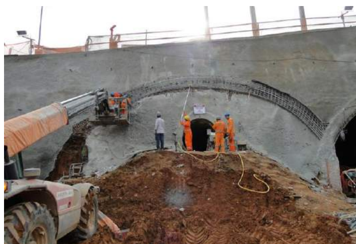
Figura 18 - Vista do deslocamento junto ao Emboque do Túnel 3B
