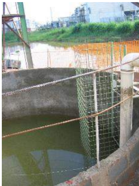
Foto 13 - Caso 10 – Poço NATM inundado
