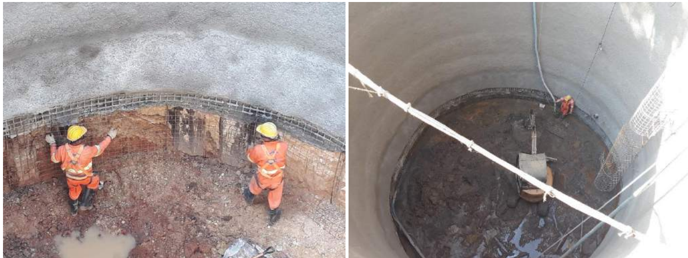
Figura 6 - Etapas de construção do poço, (a) instalação da armadura antes da concretagem, sendo possível visualizar a estaca cravada e (b) escavação no trecho de transição entre solo e rocha. (Fonte: ATO GeoCompany)
