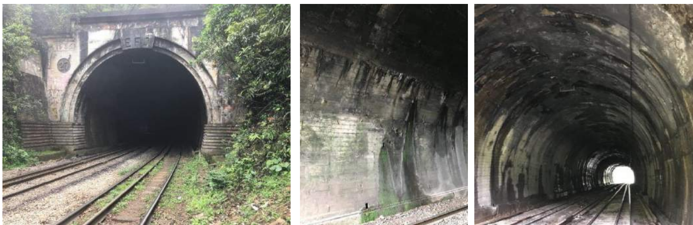
Figura 8 - Portal do Túnel 27 e exemplo de patologias encontradas ao longo das inspeções dos túneis
