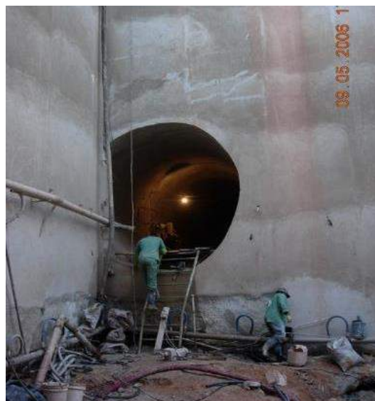
Foto 8 - Caso 8- Túnel do poço de carepa em siderúrgica - Serra/ES Diâmetro 3,70 m - Comprimento 43,40 m
