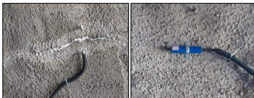
Figura 8 - A primeira imagem mostra o crackmeter instalado, a segunda mostra o datalogger
