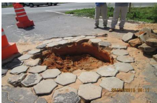
Figura 12 - Carreamento do solo "piping" entre os PV 57 e 58 (Parte Superior). Fonte: autor.
