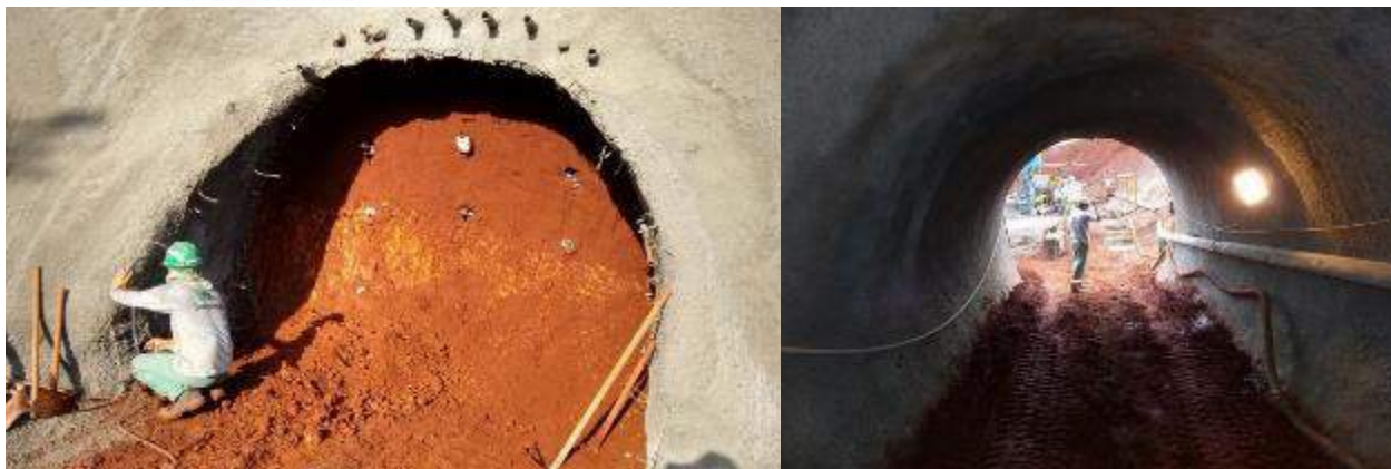
Foto 9 - Caso 9 - Túnel para pedestres sob rodovia, para indústria – Apucarana/PR Diâmetro 3,25 m – Seção útil 8,29 m 2 – Comprimento 67,59 m
