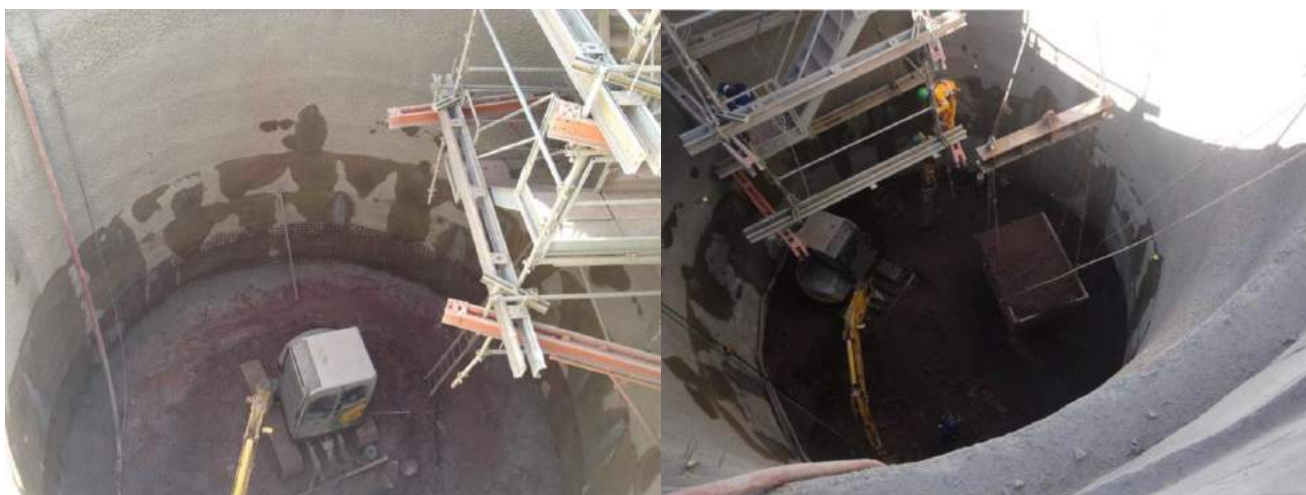
Figura 6 - Poço 1 (a) detalhe das infiltrações na face do concreto projetado e (b) atividade de escavação e limpeza do solo escavado. (Fonte: ATO GeoCompany)
