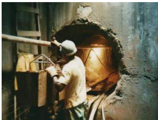
Foto 3 - Caso 3 - Túnel para passagem de cabos – São Paulo/SP – Seção útil 1,77 m 2 – Comprimento 60,0 m
