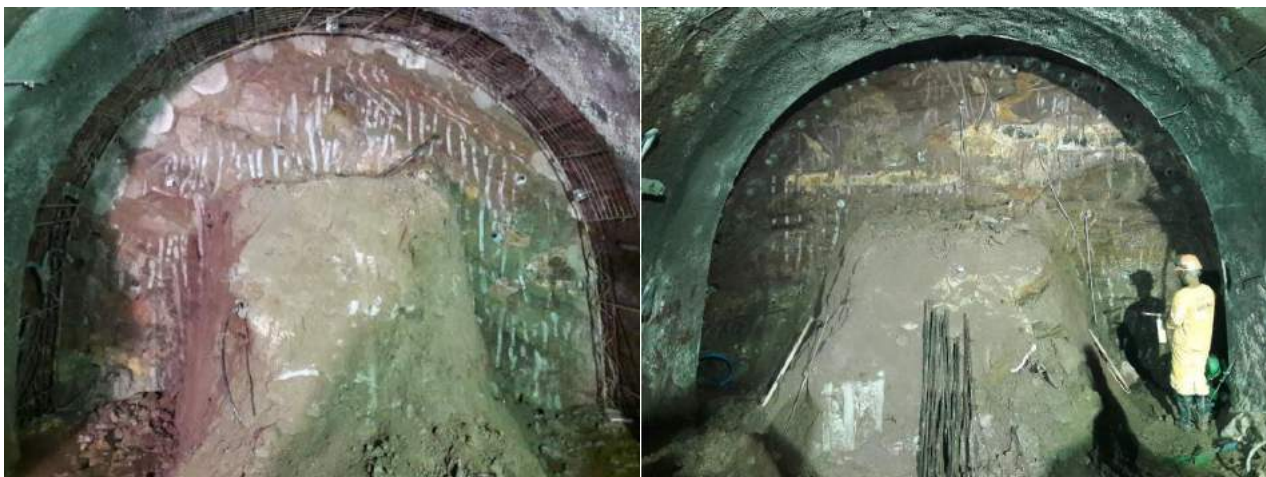
Figura 13 - Vista da frente de escavação sendo possível visualizar em (a) as colunas de CCPH e em (b) as enfilagens. (Fonte: ATO GeoCompany)
