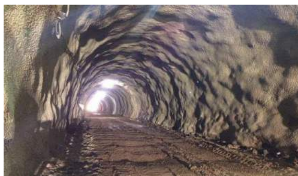
Figura 8 - Aspecto inicial do concreto projetado
